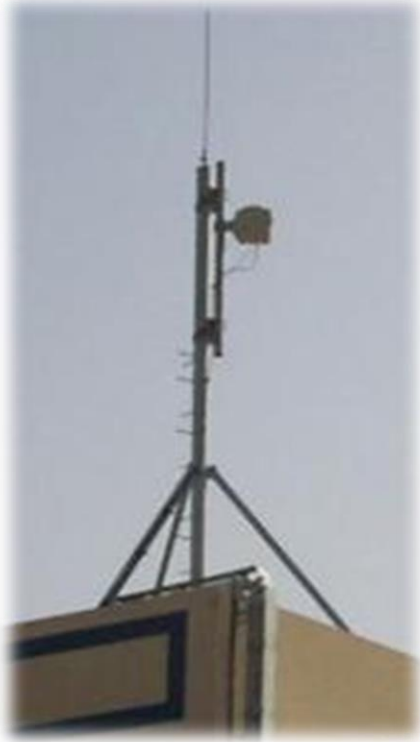
شكل رقم (٤): هوائيات مثبتة على سطح مبنى
