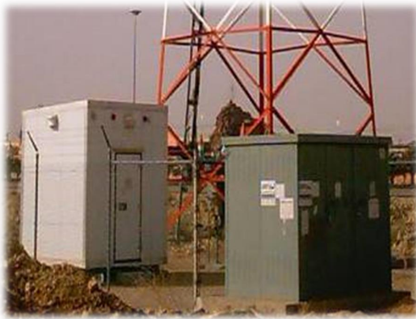
شكل رقم (٥): محطة اتصالات
