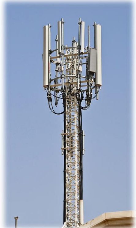
شكل رقم (٣): هوائيات مثبتة على برج
